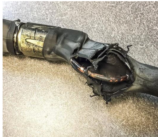
Imagen 1: Cable Dañado por un Rayo
